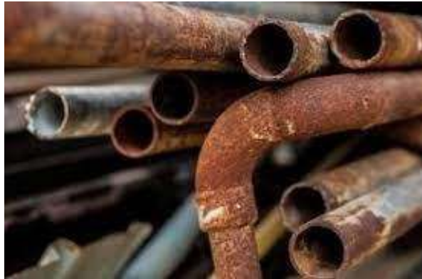
Gambar 2. 2 Logam yang mengalami korosi
