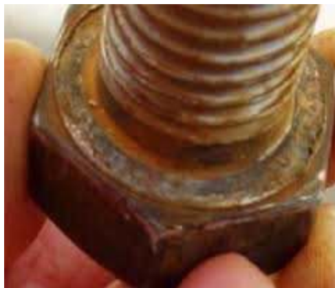
Gambar 2. 6 Korosi celah (Sumber : Jaya, dkk, 2010)
