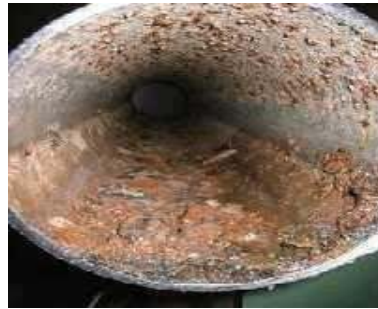
Gambar 2. 8 Korosi butiran pada pipa (Sumber : Utomo, 2009)
