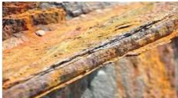
Gambar 2.2 Korosi Seragam (Sumber: M. Sholikan)
