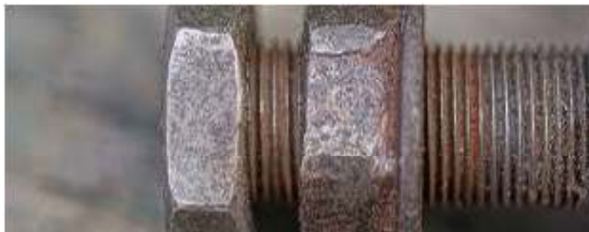
Gambar 2.4 Korosi celah (Sumber:Jaya,dkk,2010)
