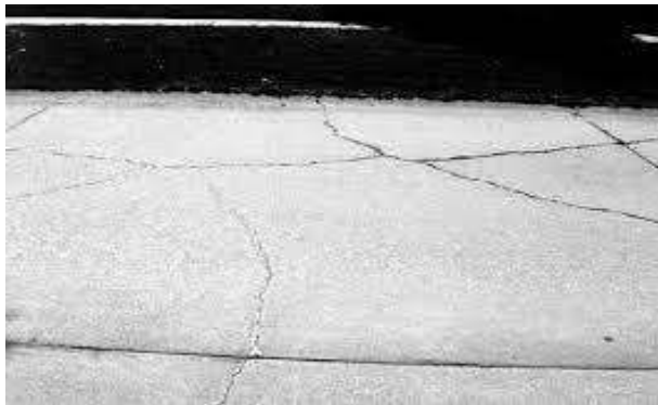
Gambar 2.23 Jalan Deformasi (Sumber: Direktorat Jenderal Bina Marga, 2017)
