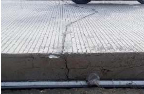
Gambar 2.22 Jalan Beton Patahan (Sumber : Direktorat Jenderal Bina Marga, 2017)
