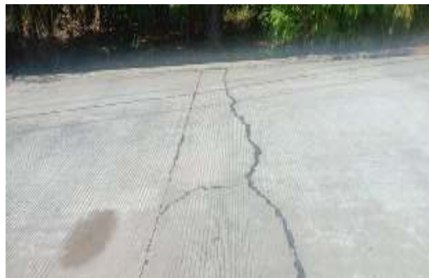
Gambar 2.21 Jalan Beton Retak Setempat (Sumber : Direktorat Jenderal Bina Marga, 2017)
