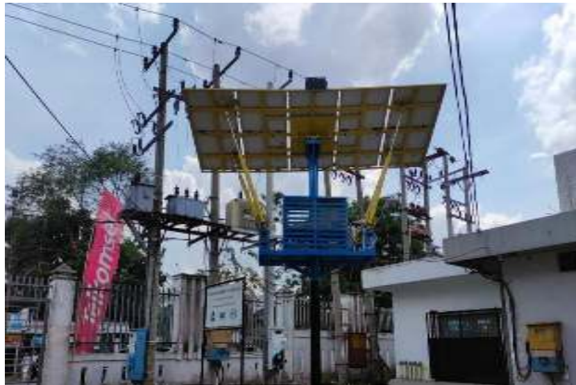
Gambar 3.1 PLTS 2 Kwp Riset Kedaireka UHN MEDAN
