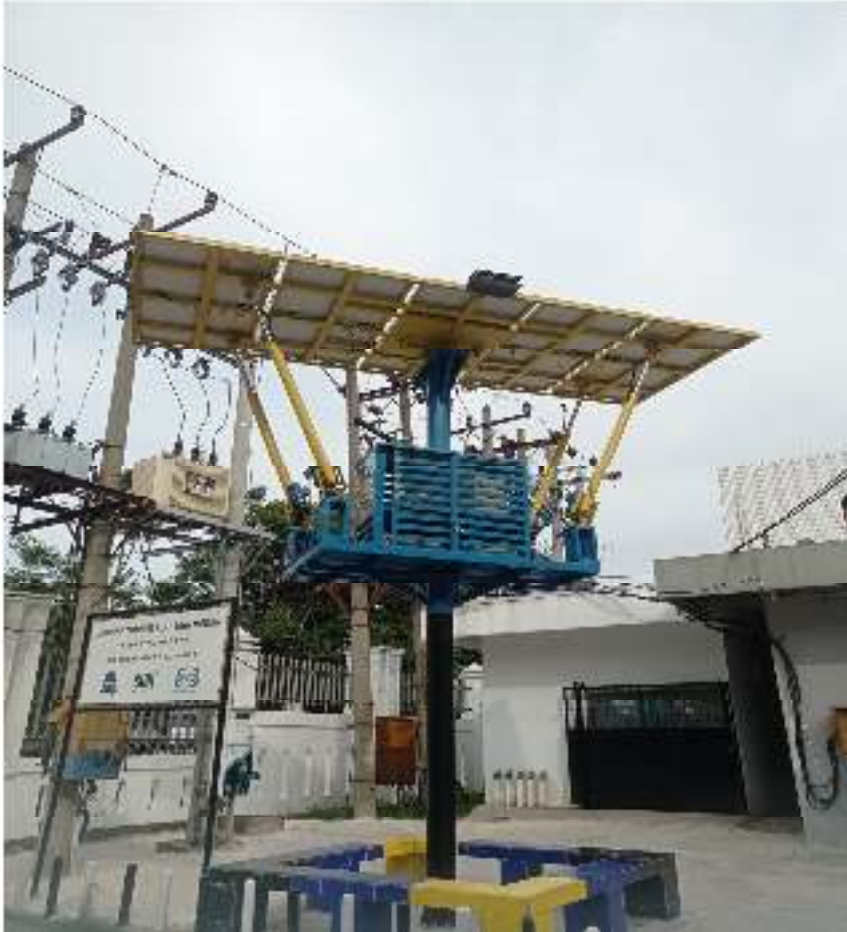
Gambar 2.1 PLTS Off Grid 2 Kwp di UHN
