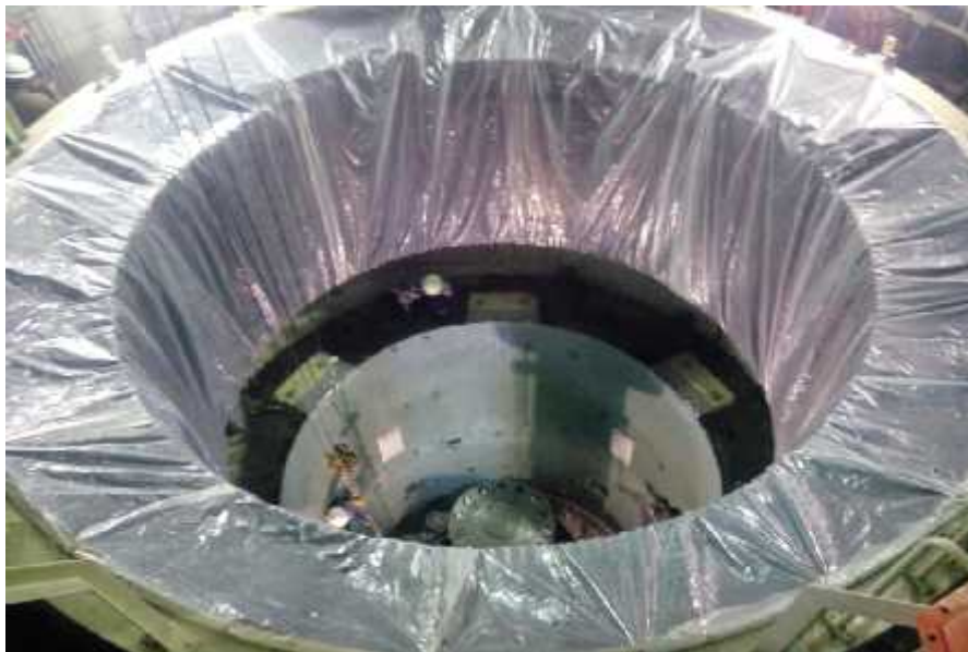
Gambar 3.9. Generator Unit 2 Pada PLTA Sigura-gura
