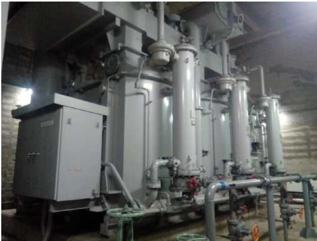
Gambar 3.10. Trafo Step Up 11 kV ke 275 kV di PLTA Sigura-gura
