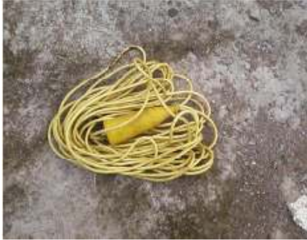
Gambar 3.3 Kabel penghubung elektroda bantu 2
