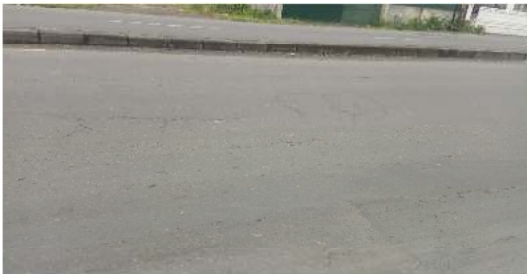
Gambar 1. 2 Retakan Badan Jalan (Sumber: Dokumentasi)
