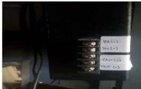
Gambar 3.9 : Terminal IN dan OUT Pada Controller
