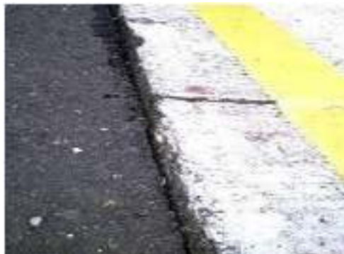
Gambar 2. 4 Retak Sambungan Bahu
