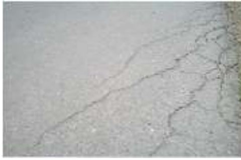
Gambar 2. 3 Retak Pinggir Jalan
