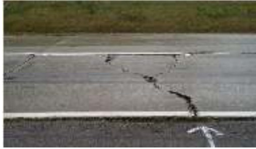
Gambar 2. 5 Retak Sambungan Jalan
