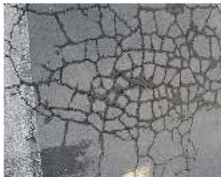
Gambar 2. 2 Retak Kulit Buaya (alligator crack)
