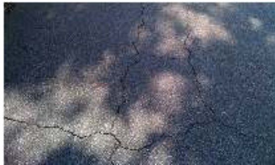
Gambar 2. 1 Retak Halus Jalan
