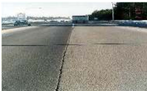
Gambar 2. 6 Retak Sambungan Pelebaran Jalan
