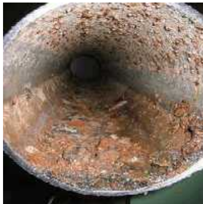
Gambar 2.7 Korosi butiran pada pipa (Sumber : Utomo, 2009)
