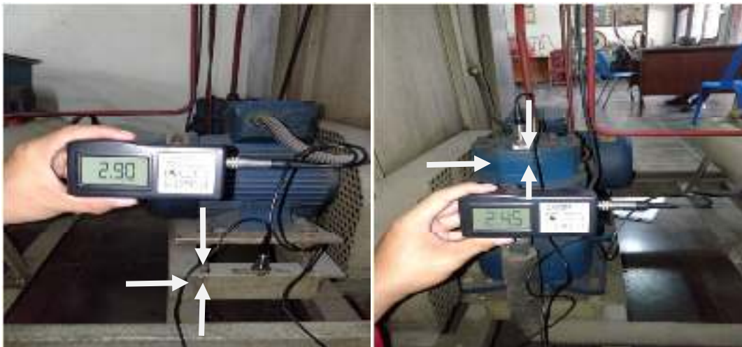
Pengukuran Velocity di landasan. Pengukuran Velocity di kompresor.
