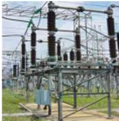
Gambar 2.12. Disconnecting Switch (DS) / Pemisah (PMS)
