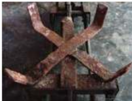
Gambar 2.1: Logam yang mengalami korosi
