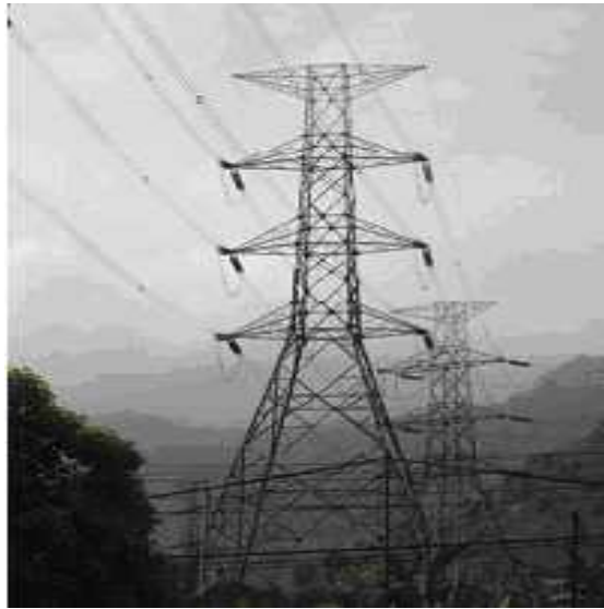
Gambar 2-2. Saluran udara (Overhead Lines).
