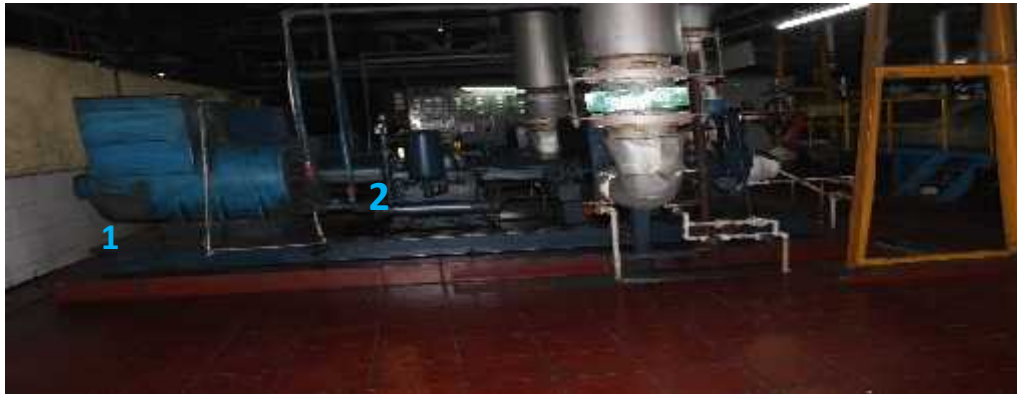
Gambar 4.1 Variasi kecepatan putaran mesin ini diukur pada empat titik pengukuran yaitu pada 2 titik pada kedudukan generator turbin uap .
