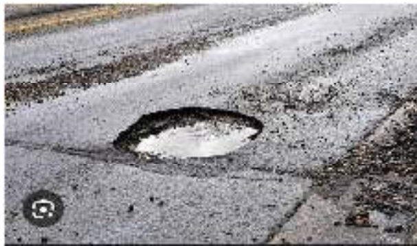
Gambar 2.7 Kerusakan lubang (Sumber : Puneekar news, 2023)
