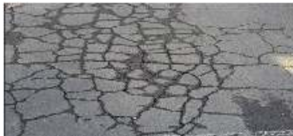
Gambar 2.5 Kerusakan retak (Sumber : Wikipedia, 2023)
