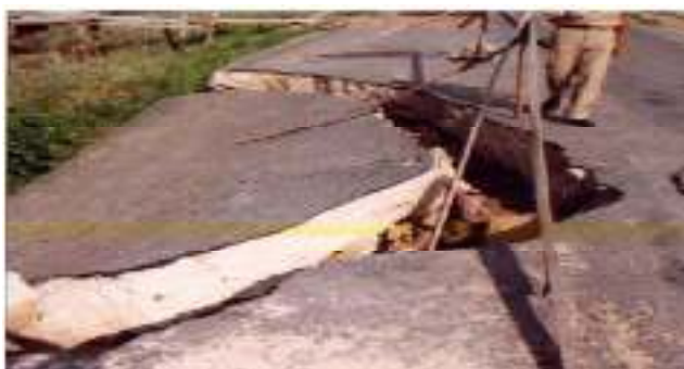
Gambar 2.9 Kerusakan amblas (Sumber : Yulianto, 2017)
