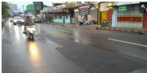
Gambar 2.4 Kerusakan tambalan (Sumber : Tribun Lampung , 2017)
