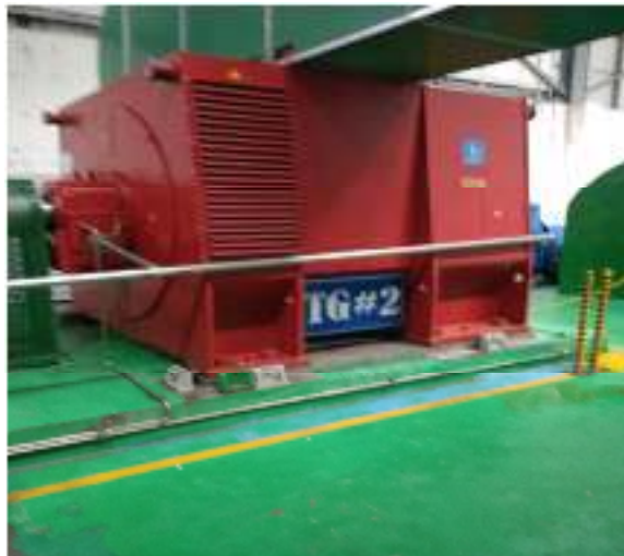
Gambar 3.9 : Generator PLTA Pakkat
