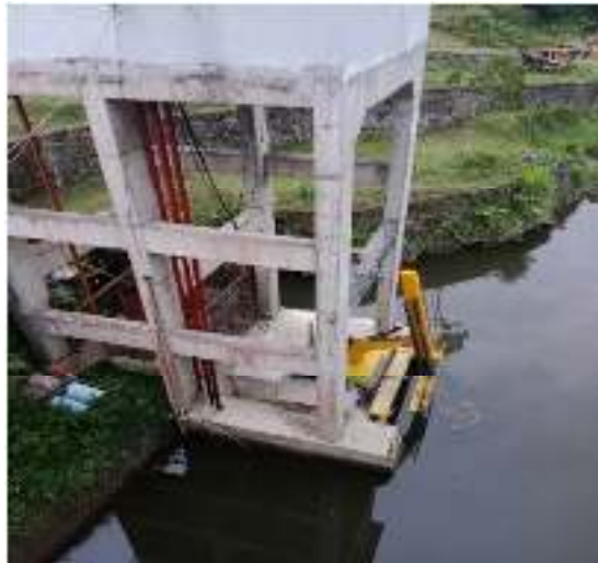
Gambar 3.4 pintu intake dan dilengkapi trashrack cleaner
