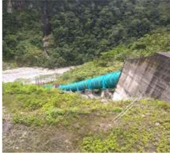
Gambar 3.6 : penstock PLTA Pakkat
