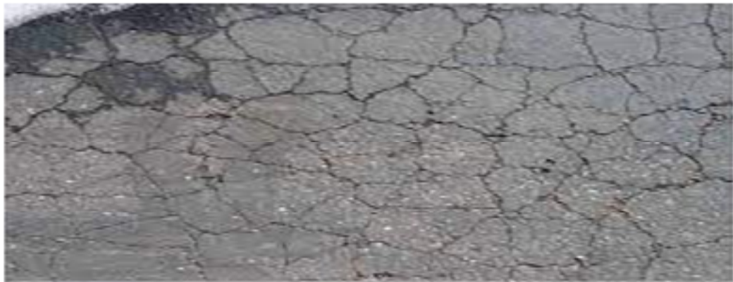
Gambar 2. 2 Retak Kulit Buaya (Sumber : Bina Marga no.03/MN/B/1983)
