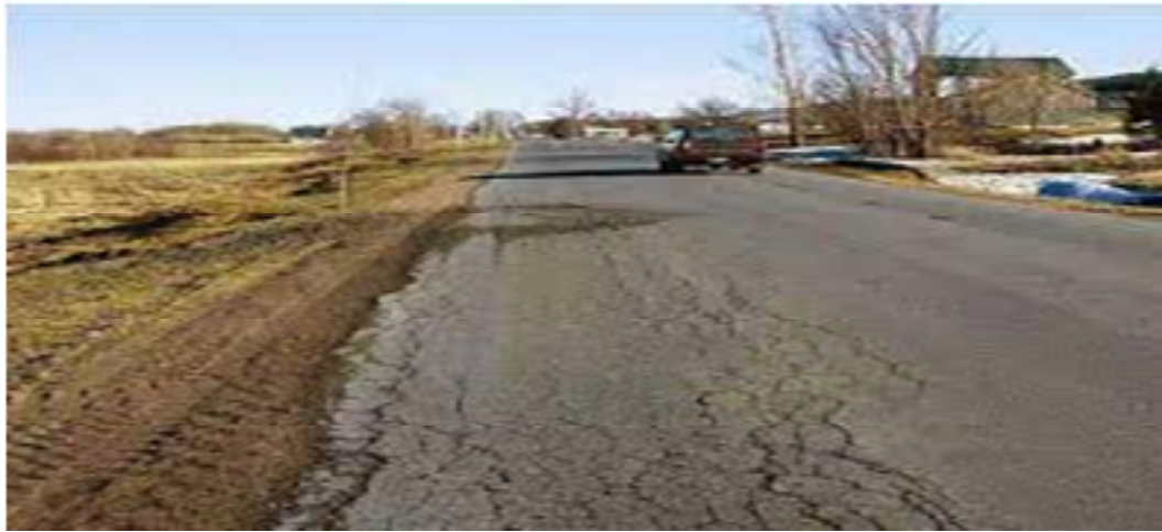
Gambar 2. 5 Cacat Tepi Perkerasan (Sumber : Bina Marga no.03/MN/B/1983)
