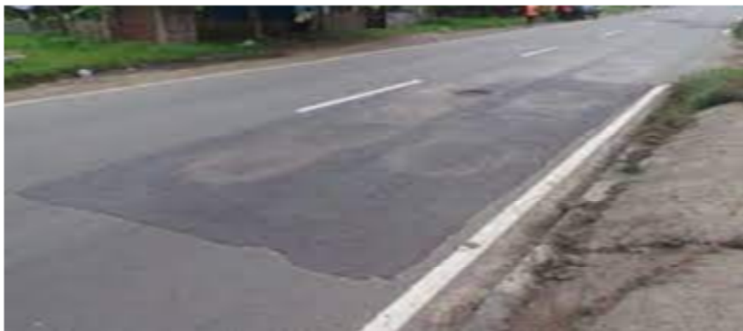
Gambar 2. 9 Kerusakan Tambalan (Sumber : Bina Marga no.03/MN/B/1983)
