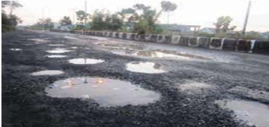
Gambar 2. 10 Kerusakan Lubang (Sumber : Bina Marga no.03/MN/B/1983)
