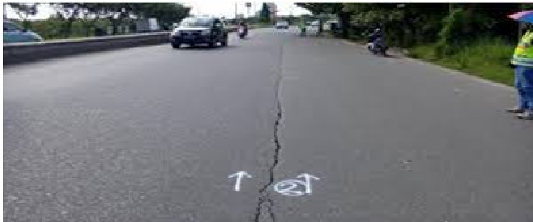
Gambar 2. 6 Retak Sambungan Perkerasan (Sumber : Bina Marga no.03/MN/B/1983)
