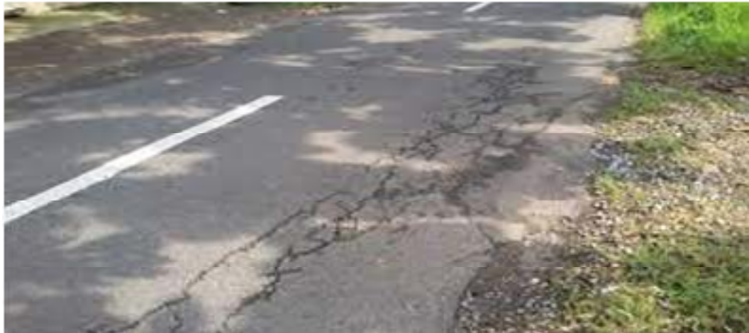
Gambar 2. 7 Penurunan Bahu Pada Jalan (Sumber : Bina Marga no.03/MN/B/1983)
