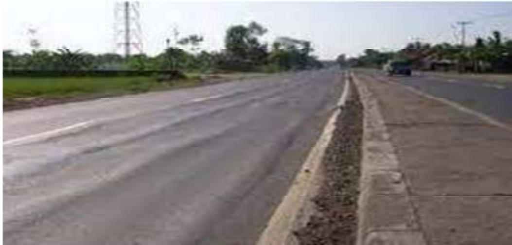
Gambar 2. 11 Kerusakan Alur (Sumber : Bina Marga no.03/MN/B/1983)
