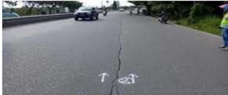
Gambar 2.6 Retak Sambungan Perkerasan
