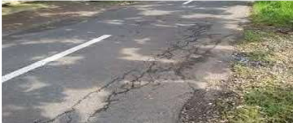
Gambar 2. 7 Penurunan Bahu Pada Jalan
