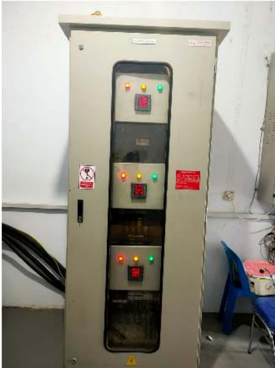
Gambar 3.4. AC Combiner (sumber : dokumen pribadi)
