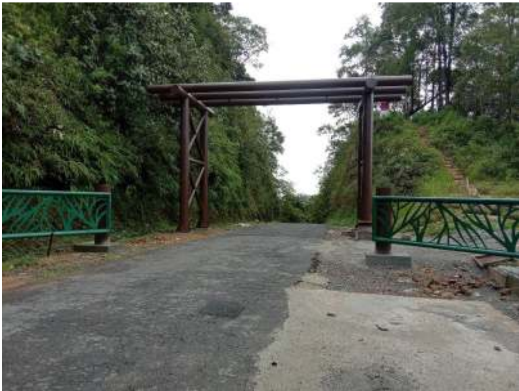
Gambar 3.3 Kondisi jalan sebelum dilakukan lapis tambah perkerasan
